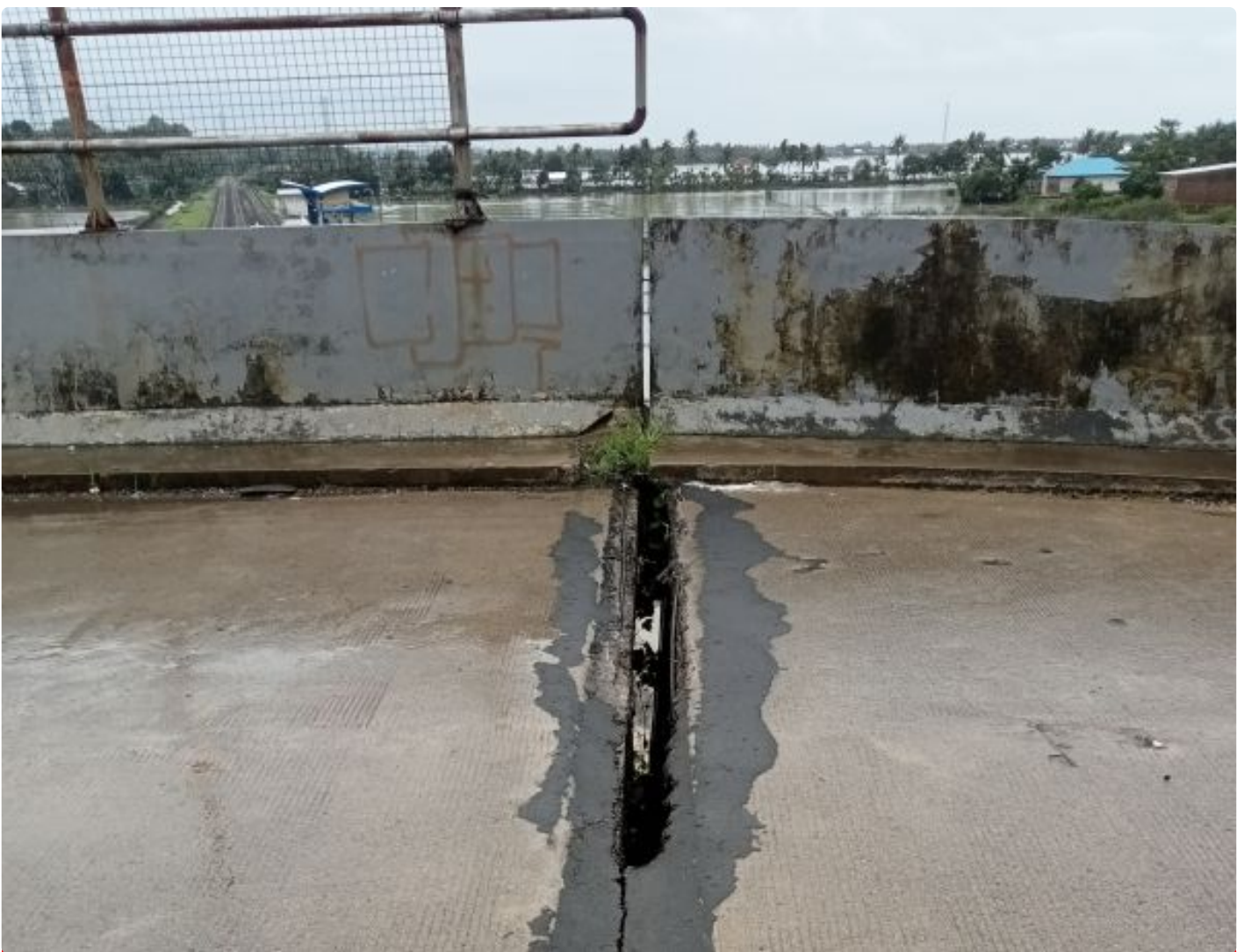
Sambungan jalan fly over Pekkae rusak parah
