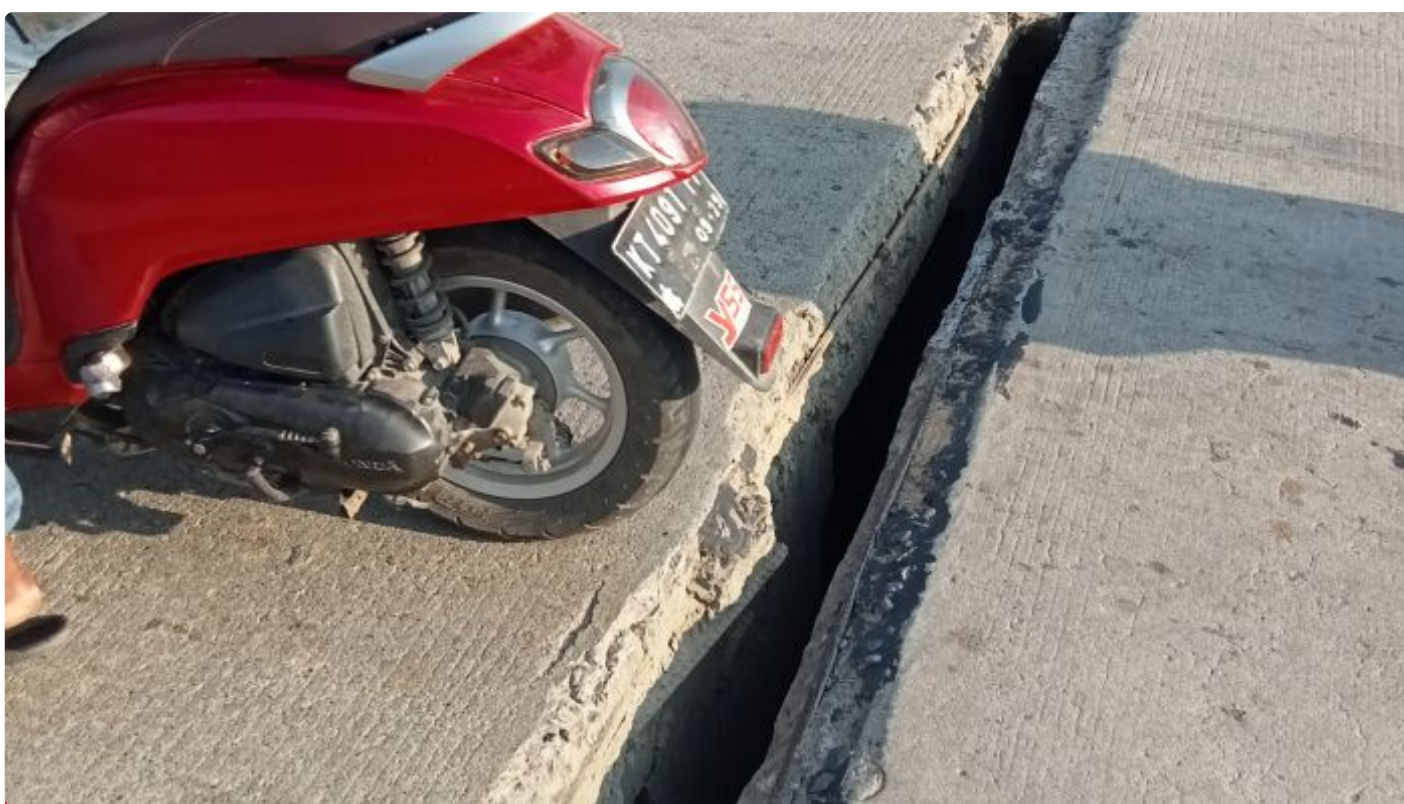
Nampak lubang selebar 20 cm di sambungan jalan fly over Pekkae
